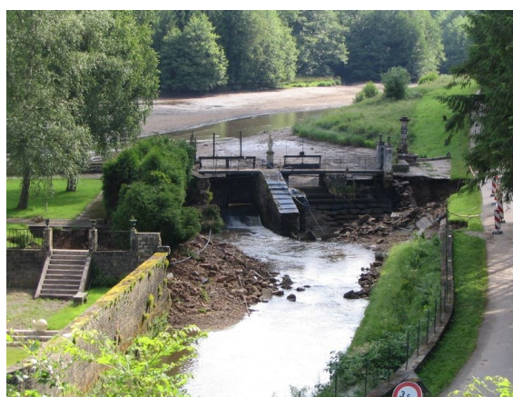
Endommagement par surverse du déversoir à DROITEVAL le 31 mai 2008 (Vosges) photo DDAF88
