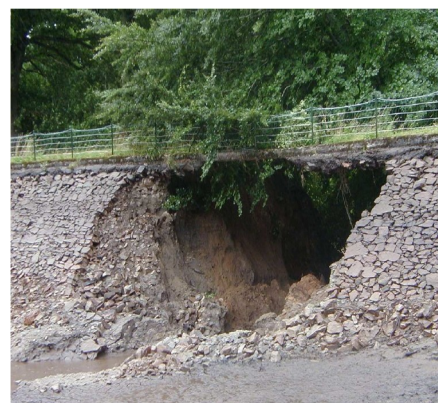
Rupture par érosion interne le long de la conduite de vidange à SAINT-GERVAIS D'Auvergne le 15 janvier 2001 (Puy-de-Dôme) photo CEMAGREF Aix-en-Provence
