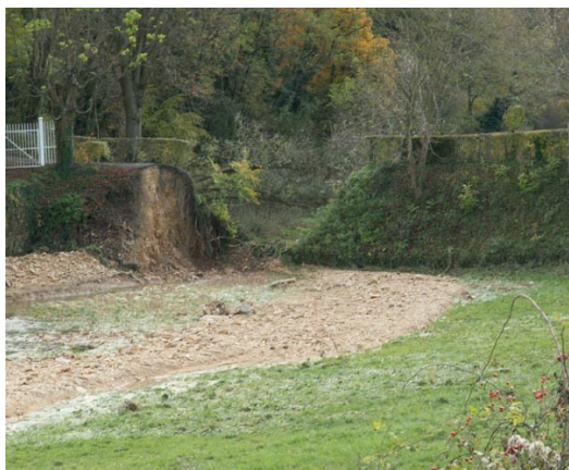
Rupture du 2 novembre 2008, commune de GLEIZE (Rhône) photo www.l-eau.fr
